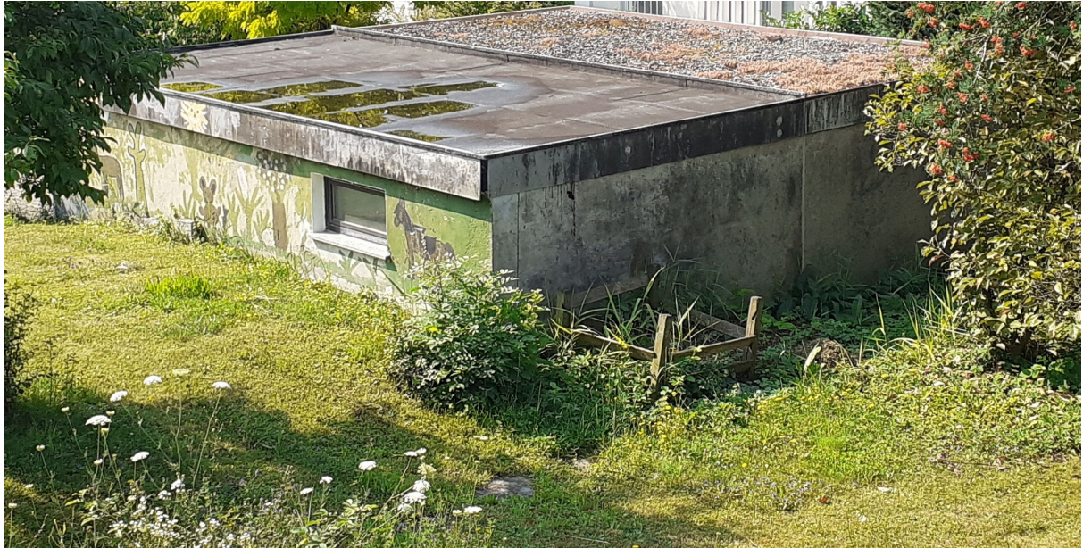
Garage mit Sanierungsbedarf
